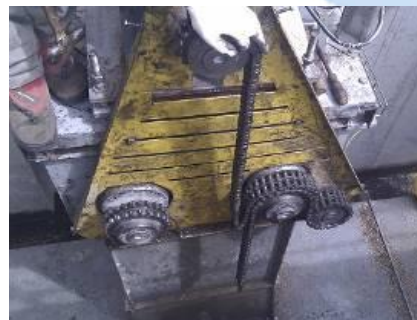
Cadena transmisión motor extracción silo
