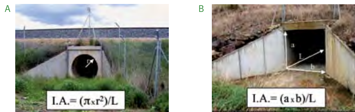
Figura 6. Ejemplos de cálculo del índice de apertura en dos drenajes de diferente sección: drenaje circular (izquierda) y drenaje adecuado (derecha).
