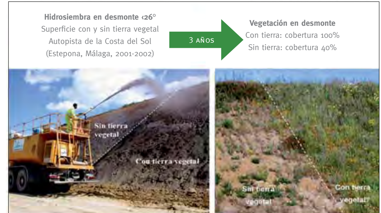
Figura 18. El efecto de la adición de tierra vegetal en la cubierta vegetal en un desmonte hidrosiembrado de la Autopista de la Costa del Sol (Málaga) fue muy patente desde un principio, así como tres años después del tratamiento. La cobertura en las zonas con tierra vegetal fue muy superior a la de las zonas sin tierra vegetal durante todo el periodo de seguimiento (3 años). Extraído de Valladares et al. , 2004.
