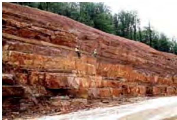
Figura 19. Aspecto de un talud Royal en construcción, en el que se están eliminando los últimos bloques inestables de forma manual. Carretera RN57, en Luxeuil, Francia (Foto: Paul Royal).
