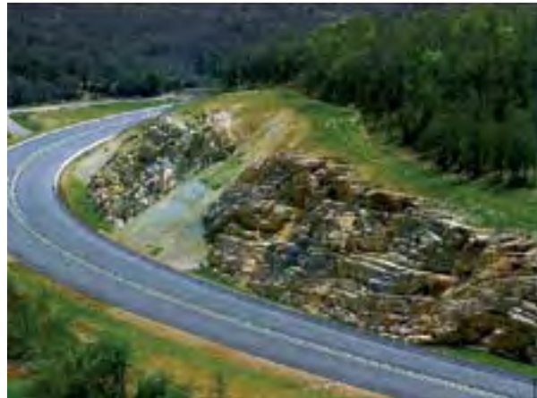
Figura 20. Aspecto de un talud Royal en la carretera Azo, Cahors (Francia) (Foto Paul Royal).
