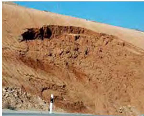
Figura 5. Ejemplo de seepage erosion en un desmante construido sobre materiales arenosos (Foto: J. Vázquez).
