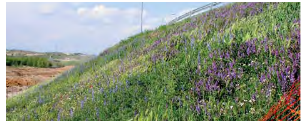
Figura 1. La cobertura vegetal de este terraplén generado durante la construcción de una autopista no se debe al éxito de la hidrosiembra realizada, ya que las especies presentes no estaban incluidas en el coctel de semillas aplicado, sino a la germinación espontánea de especies anuales que alcanzaron este escenario mediante dos posibles vías, bien por dispersión natural desde el entorno (matriz), bien al estar incluidas sus semillas en el extendido de tierra vegetal que se realizó de forma previa a la ejecución de la hidrosiembra (Foto: Ignacio Mola).
