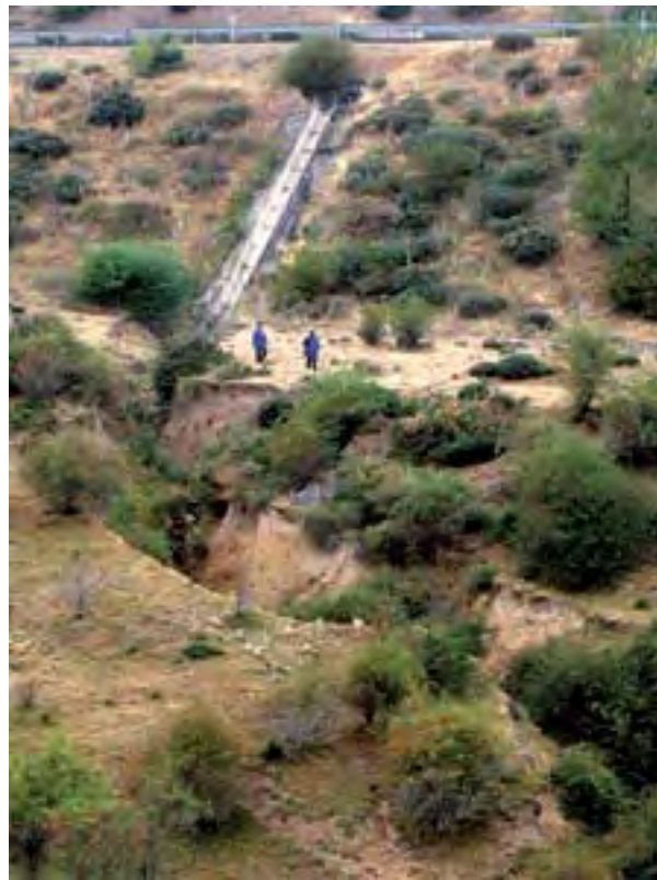
Figura 10. Formación de una cárcava a la salida de una bajante sobre un terraplén. Las cunetas de una autovía interceptan y desvían la escorrentía local, que finalmente es liberada de manera concentrada en este punto, con el consiguiente efecto erosivo (Foto: J.F. Martín Duque).
