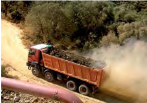
Figura 6. Emisión de polvo sobre la vegetación. La fase de construcción genera numerosos impactos sobre la flora y la fauna incluyendo el polvo, la contaminación atmosférica y el ruido (Foto: Nerea Aizpurua y Adoración Gómez).
