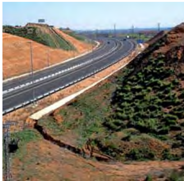
Figura 11. Formación de una cárcava a la salida de una cuneta que recoge la escorrentía procedente del ámbito de una autopista (vías y desmontes) (Foto: J.F. Martín Duque).
