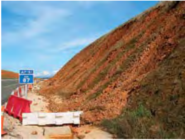
Figura 9. Deslizamientos superficiales del terreno en desmontes de una autopista, que desbaratan las actuaciones de revegetación realizadas sobre ellos (Foto: J.F. Martín Duque).
