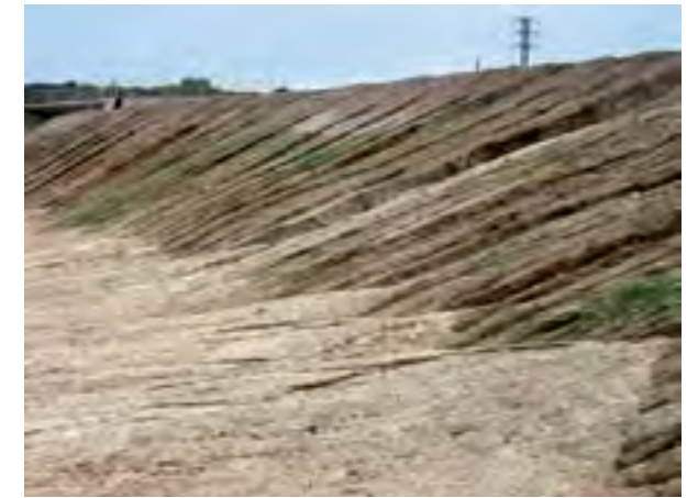
Figura 15. Erosión hídrica muy severa en terraplenes de una autovía. La paralización de las obras impidió el extendido de tierra vegetal y la revegetación durante un largo período de tiempo (Foto: J.F. Martín Duque).
