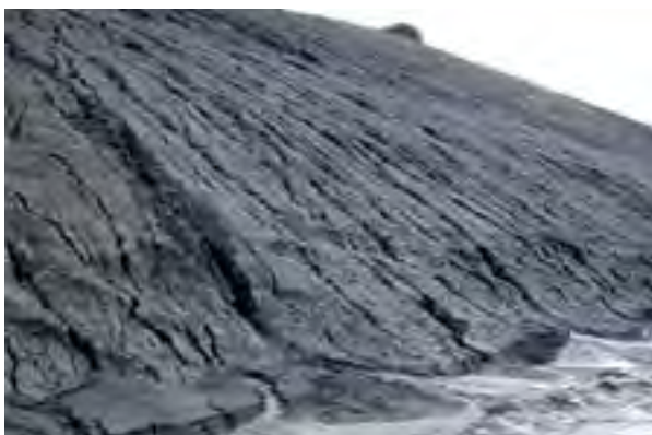
Figura 7. Grandes procesos erosivos tras una lluvia intensa en la Autopista de la Costa del Sol (Málaga) (Foto: Fernando Valladares).
