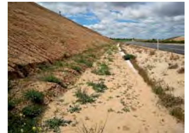
Figura 8. Acumulación de sedimentos procedentes de un desmante, que prácticamente colmata una cuneta (Foto: J.F. Martín Duque).
