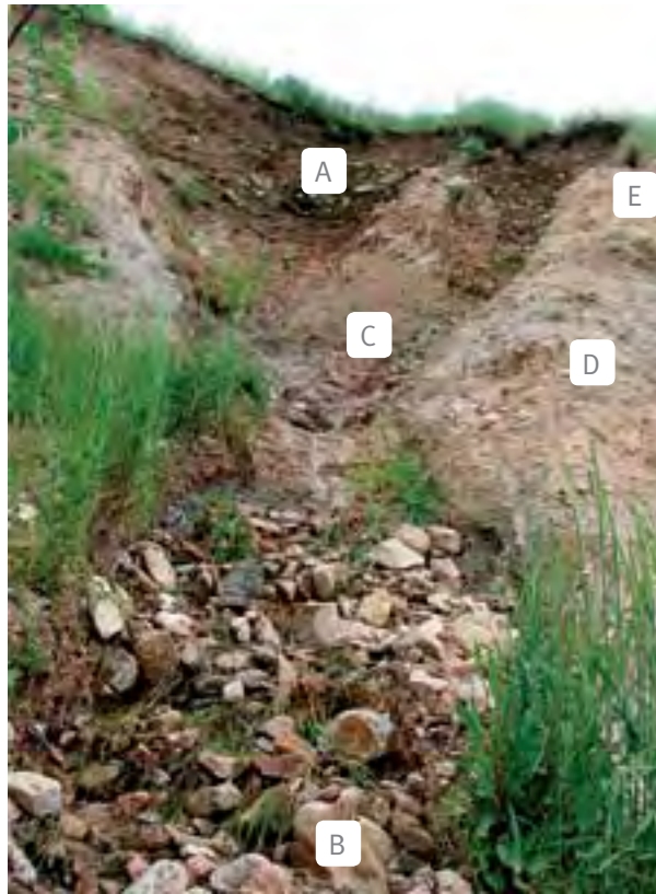
Figura 4. Cabecera de deslizamiento (A) y derrubios movilizados (B) en un desmante de carretera, a favor de una surgencia de agua (C) producida en el contacto entre una roca impermeable (D) y unos cantos y bloques permeables (E), correspondientes a un depósito de abanico aluvial (Foto: J.F. Martín Duque).
