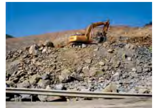
Figura 5. Movimiento de tierras y generación de taludes durante la construcción de una autopista (Foto: Nerea Aizpurua y Adoración Gómez).
